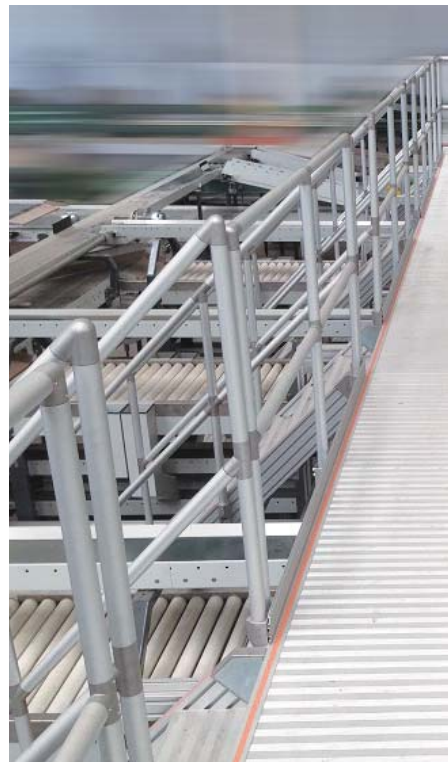
Bridge for Sorting Machine 分拣设备过线梯
